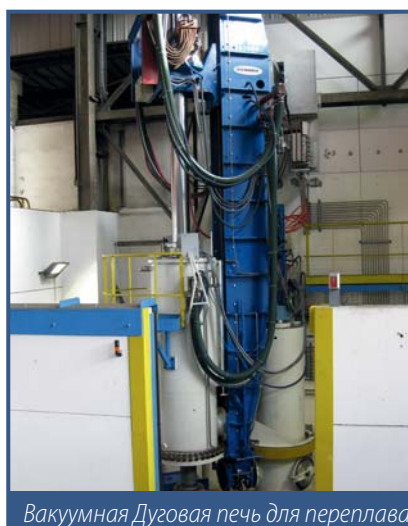
Печь для литья с расходной электродной.
